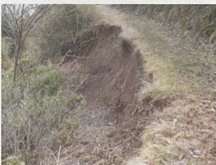
道路の崩壊（回復不可）
